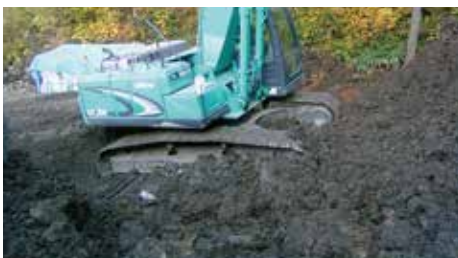
② 崩落土（バックホウ走行不可）
