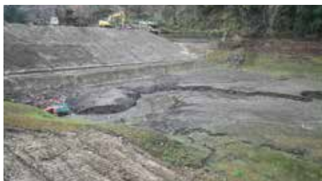
① 底泥土の堆積状況
