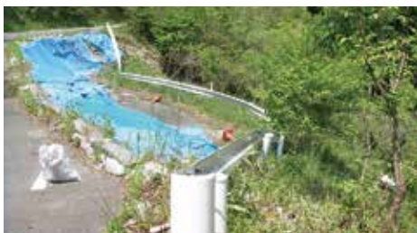
① 着工前全景（路肩部崩落）
