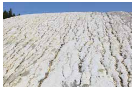
安定処理土 ガリ侵食多数
